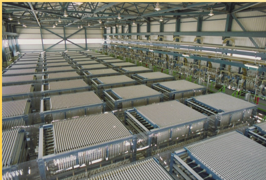
Hala s membránovými elektrolyzéry
